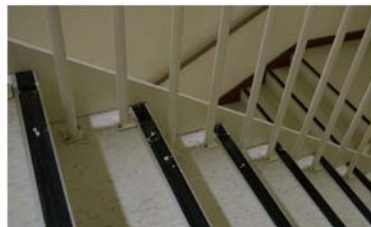
高出梯級5公分的防護緣
