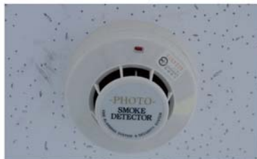
◎ 攝自內政部多功能輔具資源整合推廣中心 煙霧偵測器
